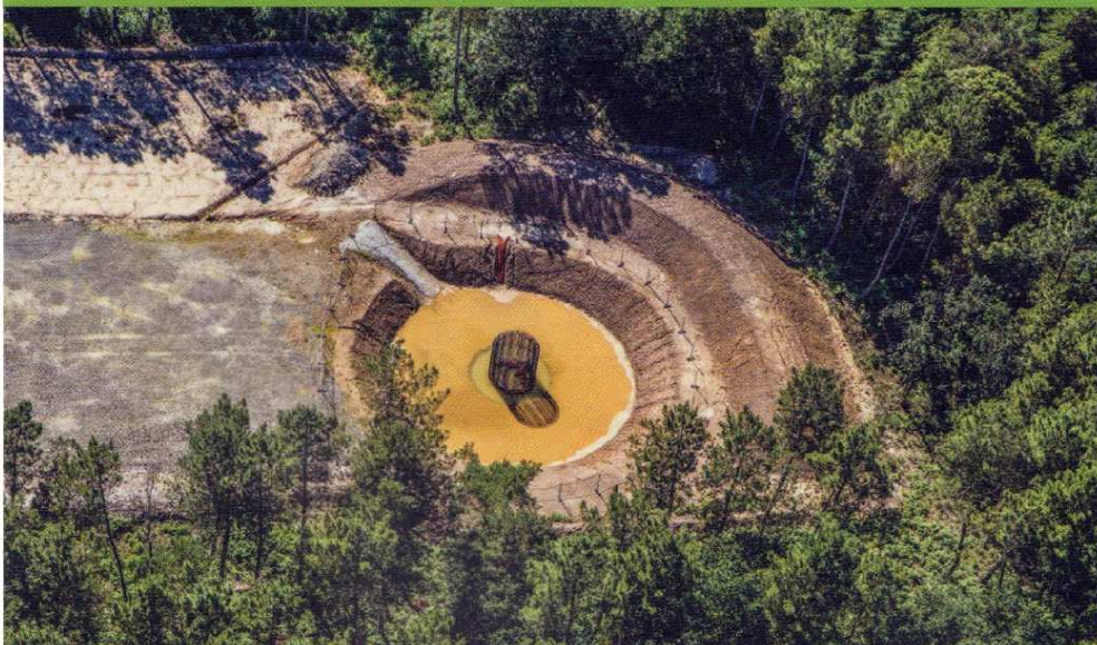
Les socles d'éoliennes sont restés tel quels depuis juillet 2017. Si certains ont été protégés par des blocs de bétons, d'autres, laissés en plan, s'affaissent au fil des précipitations.
